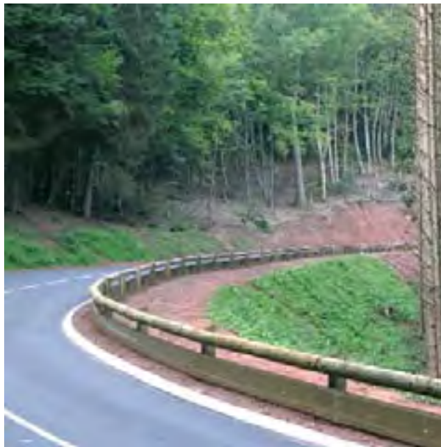
Imagen nº4 Ejemplo Barrera Mixta con protección de Motoristas
