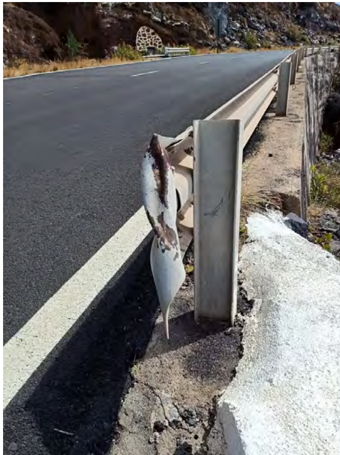
Imagen nº2: Perfil IPN y Oxidación de la barrera de contención
