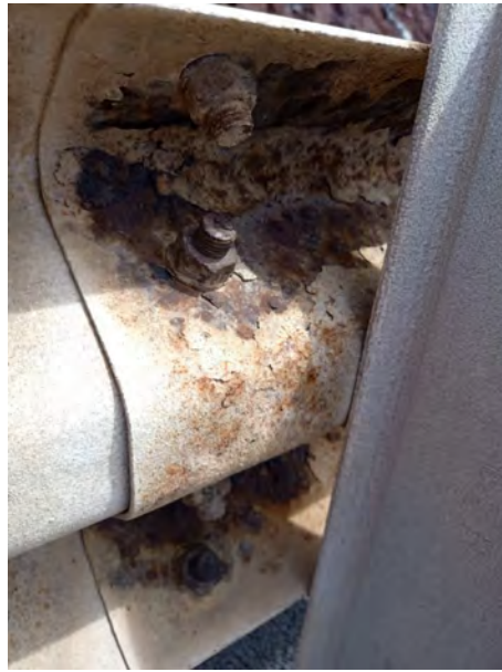
Imagen nº1: Estado Actual de los Anclajes
