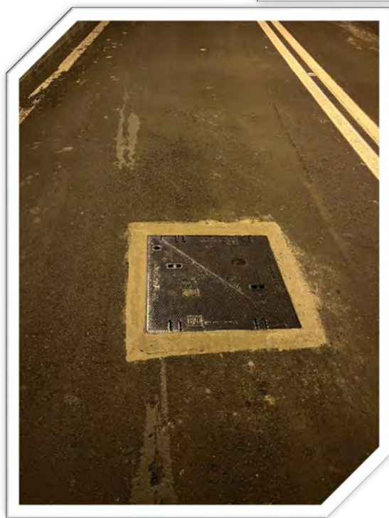
Imágenes 11,12,13: Arquetas e imbornales a sustituir y reforzar.
