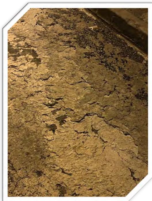
Imagen 9: capa de Gunita y ausencia de señalización horizontal
